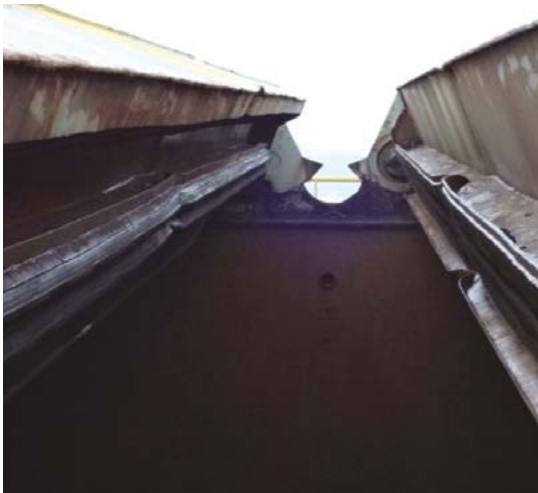
舱盖接缝处 胶条和压条变形
