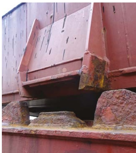
定位装置磨损严重
