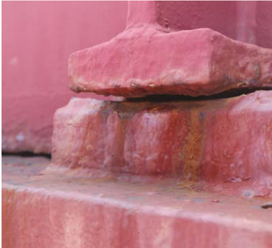
支撑块磨损严重
