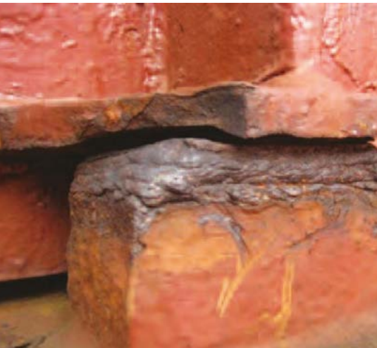
支撑块磨损后不恰当的临时修理 (来源:UKP&I)
