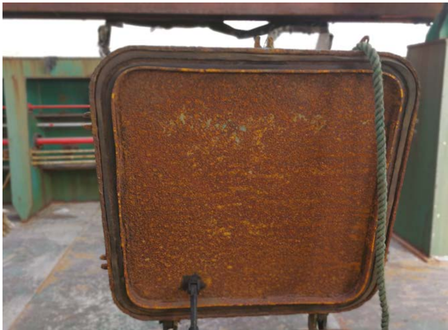
下舱人孔盖密封胶条状况差
