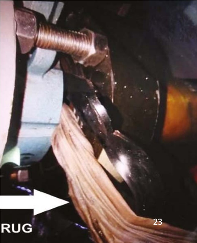
污水井阀被破布堵住
