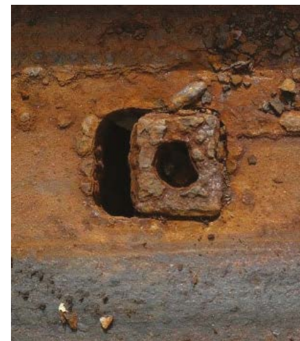
压紧螺丝锈蚀已长时间不用
